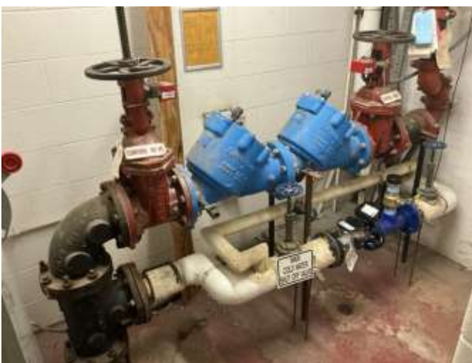
29 - FIRE SPRINKLER RISERS
